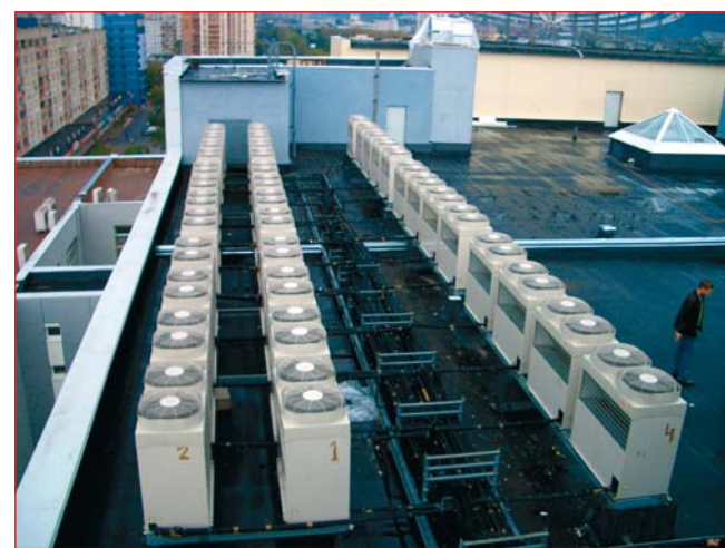
Наружные блоки, установленные на кровле здания торгового центра
